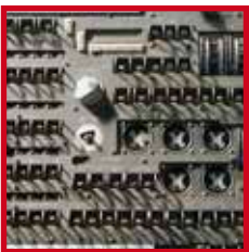
Salas de control
